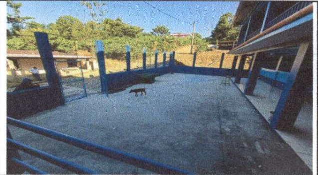
Fotografía 8. Reparación de muro perimetral de block con tubo hg y malla galvanizada, soleras intermedias y columnas de todo el establecimiento.
