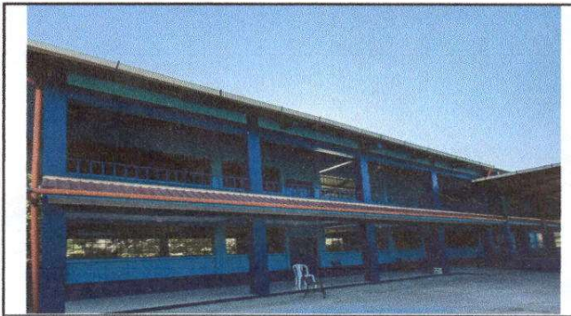
Fotografía 3. Canales y Bajada de agua pluvial en todo el establecimiento
